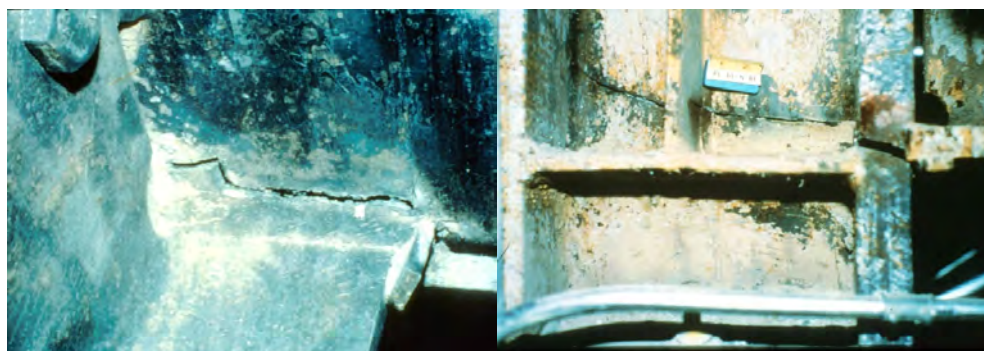
Fractura en la junta viga-columna
