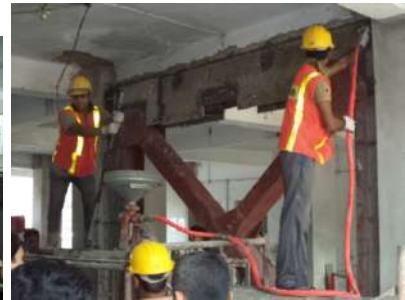
(iv) Mortero / lechada o sin contracción presionado en la parte superior en progreso
