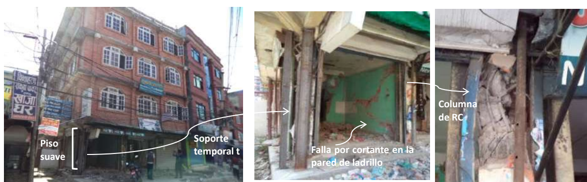
Figura E-2.24 Daños en el edificio (2) debidos al terremoto de 2015 en Gorkha, Nepal
