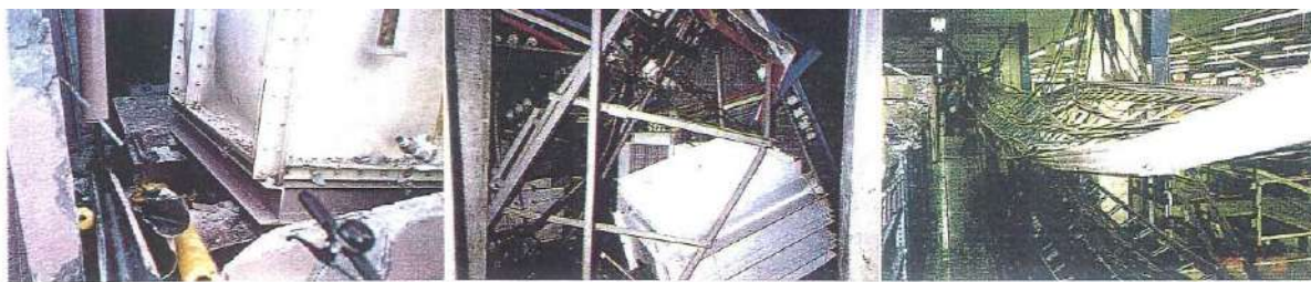
Deslizamiento del tanque de agua
