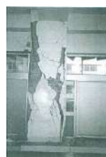
Grado de daños IV
